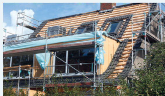
Anche l'ermeticità all'aria degli edifici esistenti offre un grande potenziale per la prevenzione dei danni strutturali e il risparmio energetico
